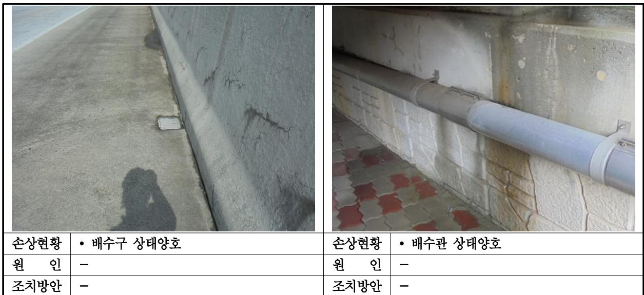
【사진 35.3.20】 배수시설 손상현황
