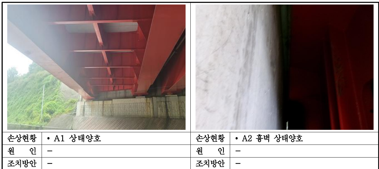
【사진 35.3.9】 교대 손상현황
